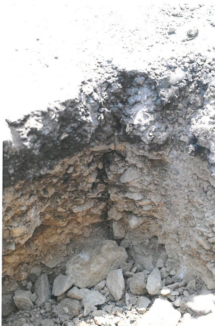
Obrázek 3 – Kopaná sonda K.S. 3 v místech výrazných trhlin na povrchu. Kopaná sonda prokázala původ trhlin ve vozovce z podloží komunikace. Na obrázku patrný prostup trhliny z podloží k povrchu vozovky.
