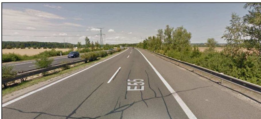
Mot. 1: Příklad popraskání a následného sanování vozovky na komunikaci evropského významu – Dálnice D8, úsek Úžice – Nová Ves, rok 2014 (google.maps).
