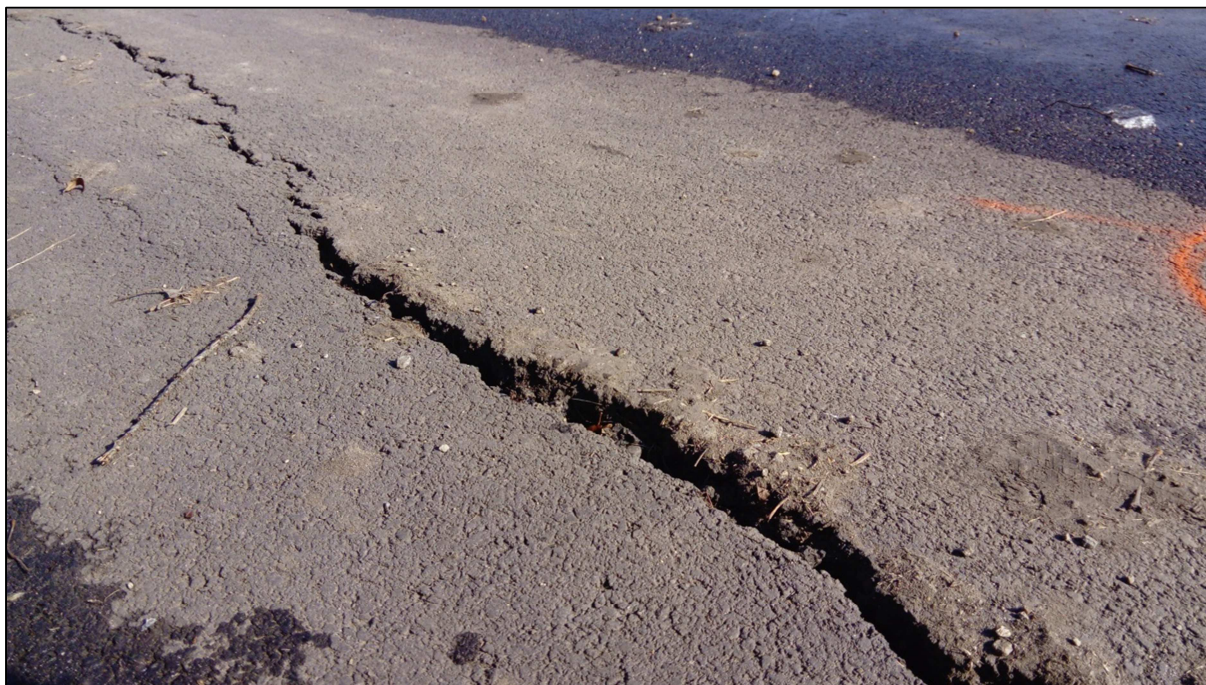
Foto 6: Detail trhliny na fotografii č. 5. Trhlina je relativně masivní, blonbka se pohybuje v řádu dm, šíře 2 – 3 cm, výškové odsazení 1 – 2 cm.
