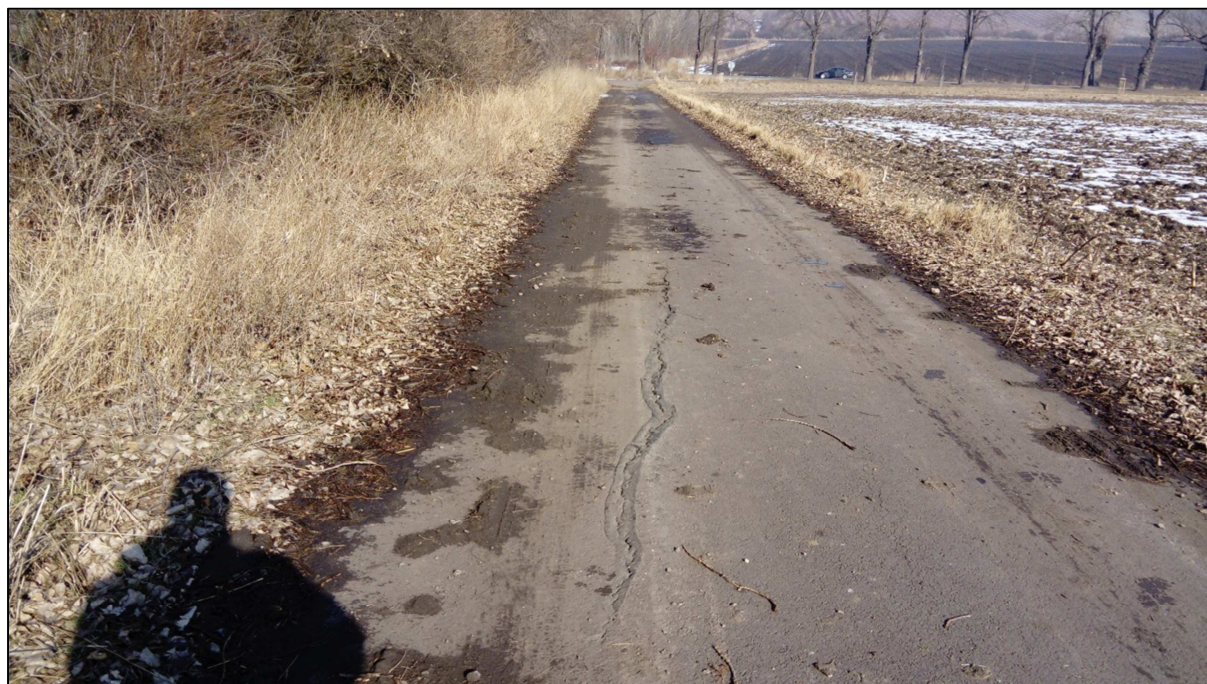
Foto 1: Pohled přibližně z 1/2 délky třetí části „1. větve“, tj. v místech počátku větších poruch. Trhlina na fotografii je pokračování původní trhliny na místě zalití pružnou asfaltovou záclivkou.
