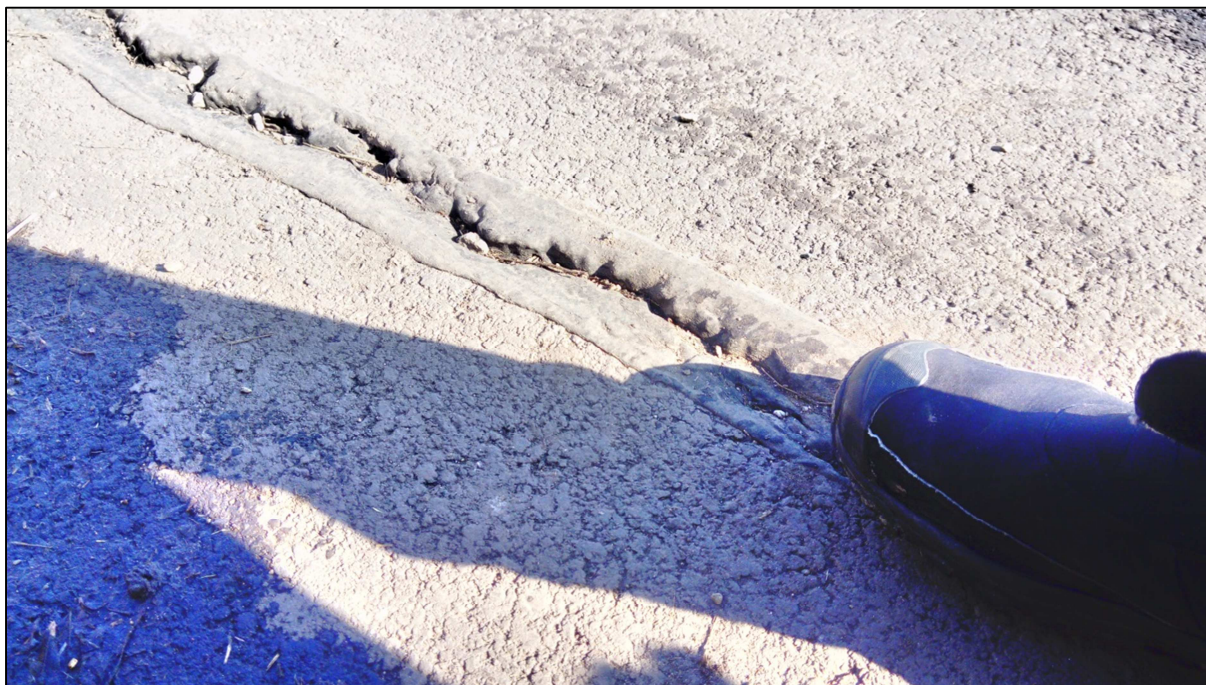
Foto 4: Detail trbliny v místě zalití původní. Šíře se pohybuje v řádu prvních cm, hloubka několik dm. Většina trblin má výškově odsazené okraje.
