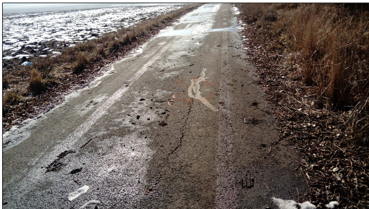
Foto 2: Trhliny nové nejsou patrné pouze v místech trhlin starých – sanovaných, ale také coby nové na původní poruše částečně závislé či zcela nezávislé propagace a poruchy. Podle stop automobilu je dobře čitelná šíře komunikace.
